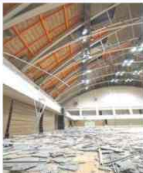
天井が落ちた市民体育館
