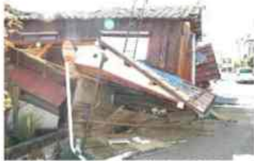
倒壊した家屋(川東地区随所)
