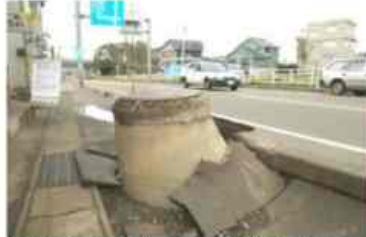
隆起したマンホール(川東地区随所)
