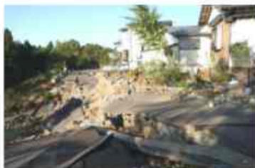
崩落した道路(川東丘陵地)
