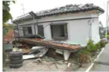
一階部分潰れた家屋(川東地区随所)
