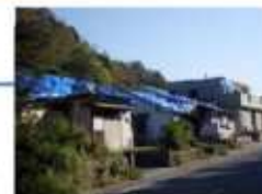
住宅の被害写真(飯沼町岩井地区)
